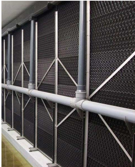
Detail filtermateriaal in chemisch luchtwassysteem (bron: Inno+)
