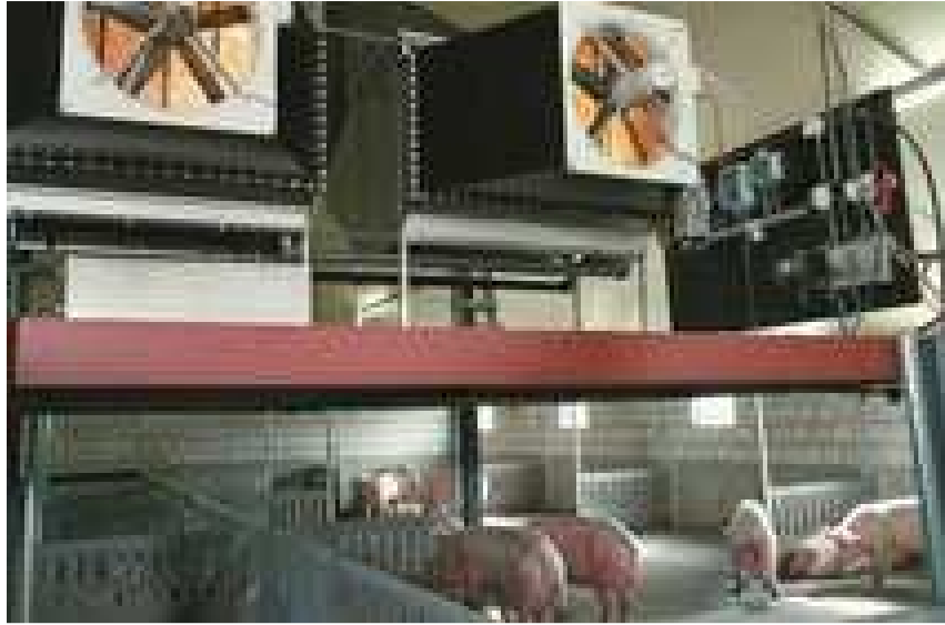
Ventilatoren op centrale plaats tussen dierruimte en luchtwasser (bron: Uniqfill Air B.V.)
