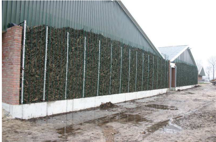
Biowand bij toepassing van een gecombineerde luchtwasser (bron: Inno+)
